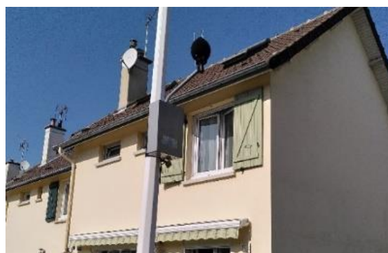
Station de mesure ; rue des Iris à Saint-Ouen-l'Aumône.
